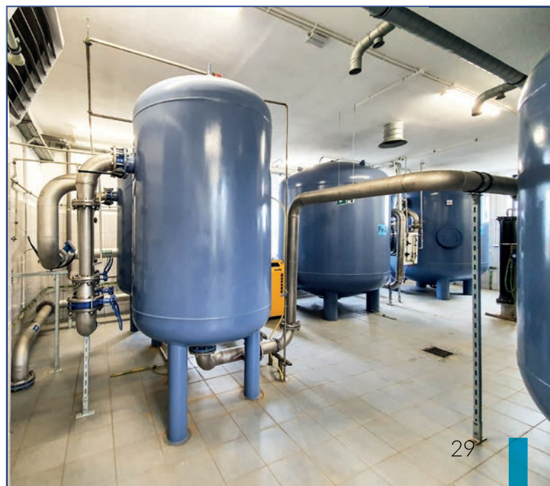
Fot. 2 | Stacja uzdatniania wody w Płonce-Strumiance
